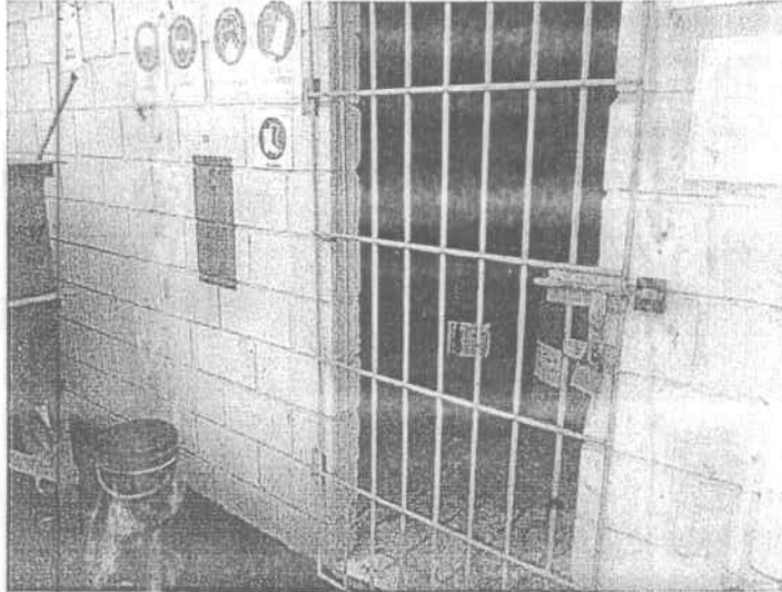
Foto 1. Área de almacenamiento de Ácido Sulfúrico. No cuenta con sistema de contención de derrames y tampoco se encuentra impermeabilizado.
